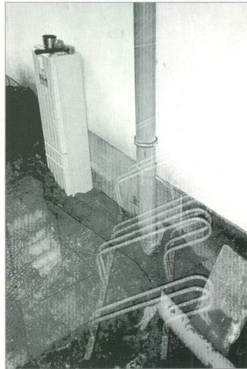
Der Schaltkasten für die Pumpen
