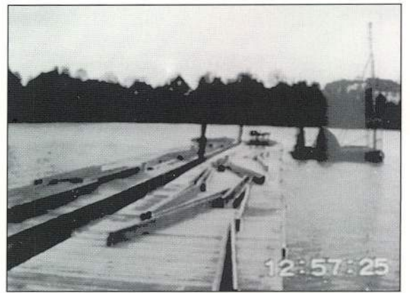
An den Pfählen, die Helmut eingerammt hatte, befestigten wir die Schwimmbrücke für die Endmontage
