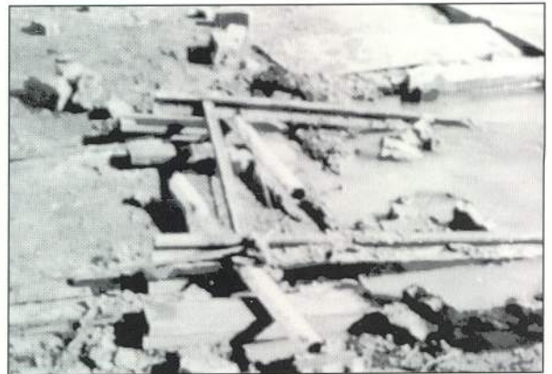
Der Ponton des Baggers hatte unsere Slipanlage zusammengeschoben. Auch ein Taucher, der die Slip inspizierte, konnte nicht mehr helfen, sie mußte raus
