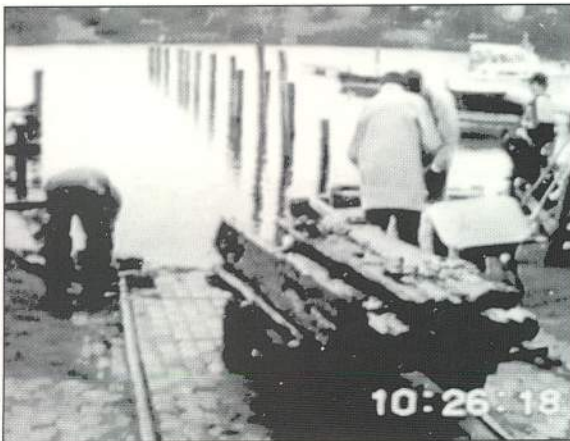
Von der mit der Winde herausgezogenen 18 Meter langen Slipanlage, blieben diese total vermoderten Schwellen übrig. Die verbogene Schiene mußte gerichtet werden.
