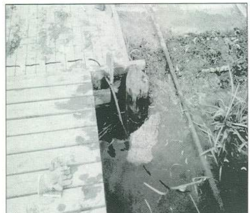
Ein Erdkabel wurde für die Bootswaschanlage verlegt, im Wasser gesichert in einem Kunststoffrohr 1994
