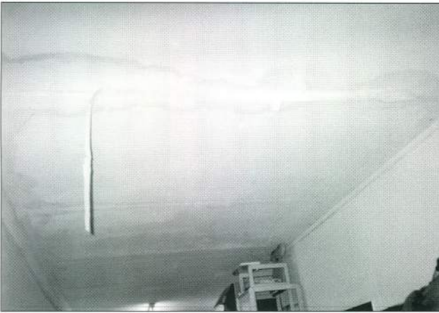
Die Wasserschäden an der Decke sind gut erkennbar
