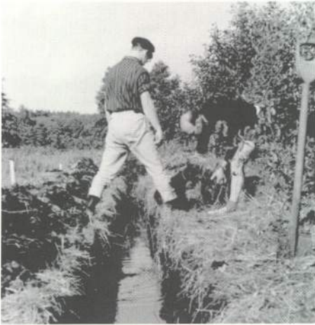
Entwässerungsgräben müssen sein
